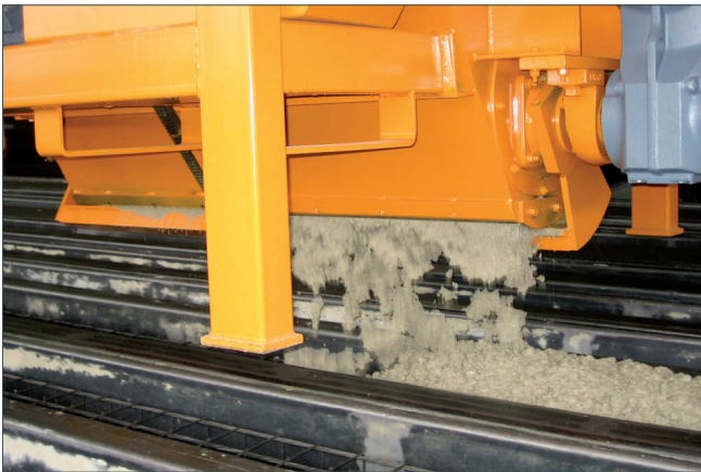
Vanne segment avec rouleau de distribution
