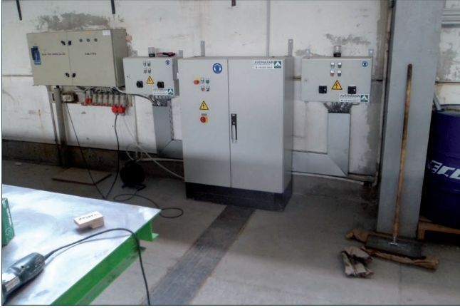
变频控制器和配电箱
